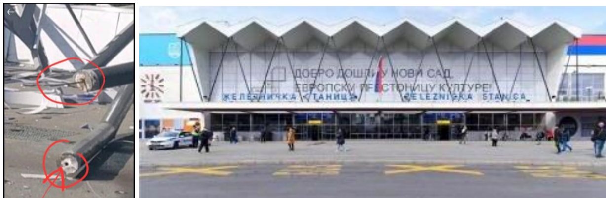
Сл.12. Фотографије после колапса конструкције надстершнице железничке станице у Новом Саду.
